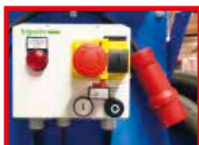
Quadro elettrico trifase
