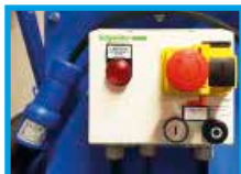
Quadro elettrico monofase
