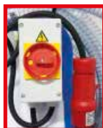
Quadro elettrico trifase
